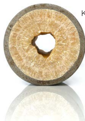
Kalkaflejring i drikkevandsrør
